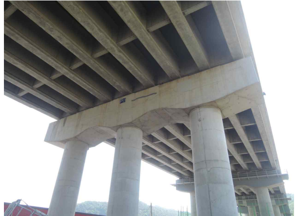
P11 교각 출입시설 및 점검통로 미설치
