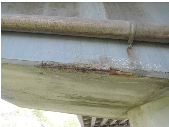
P12 교각 철근노출 및 박락 (0.3m×1.0m)
