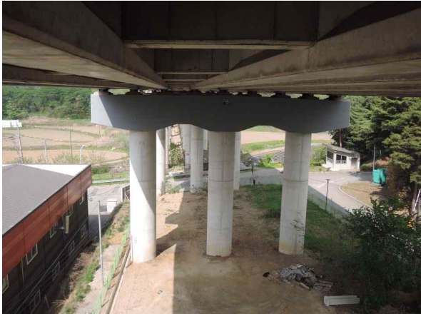
P8 교각 출입시설 및 점검통로 미설치
