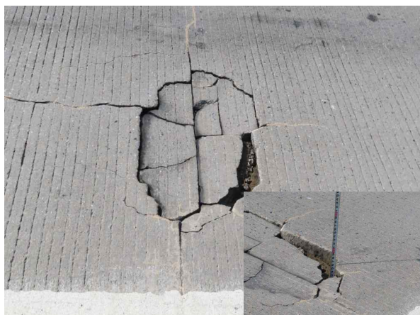
S3 교면포장 파손 ( 0.6\text{m} \times 1.0\text{m} , t=60\text{mm} )
